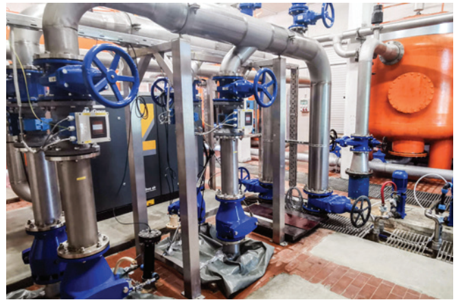
| Del tehnološke opreme v Vodarni Medlog (peščeni filtri, ogljeni filtri, ozon, črpalke, pipe za vzorce, nadzorni sistem na ekranu ...)
