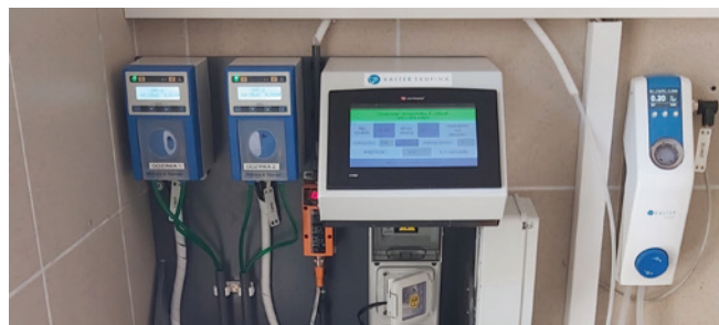
Na sliki je naprava za doziranje natrijevega hipoklorita. Kloriranje vode se v večini primerov ni mogoče izogniti, ker nam predstavlja glavno orožje proti pojavu sekundarne zarasti mikroorganizmov v vodovodnem omrežju.
