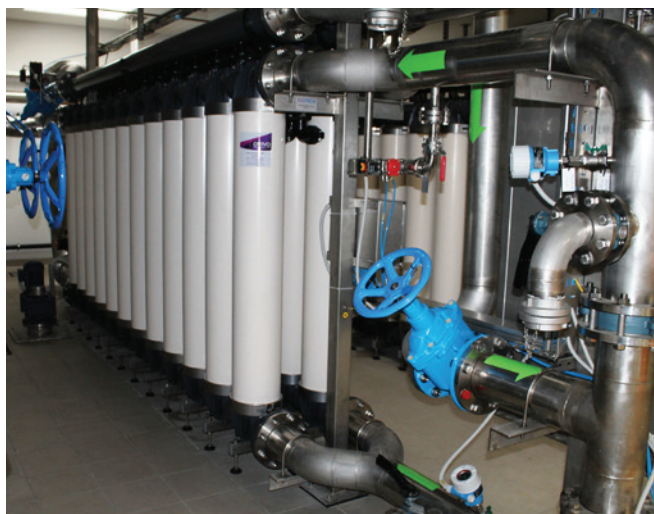
Zaradi membranske filtracije je vodarna Frankolovo postala zelo stabilen vodni vir.
