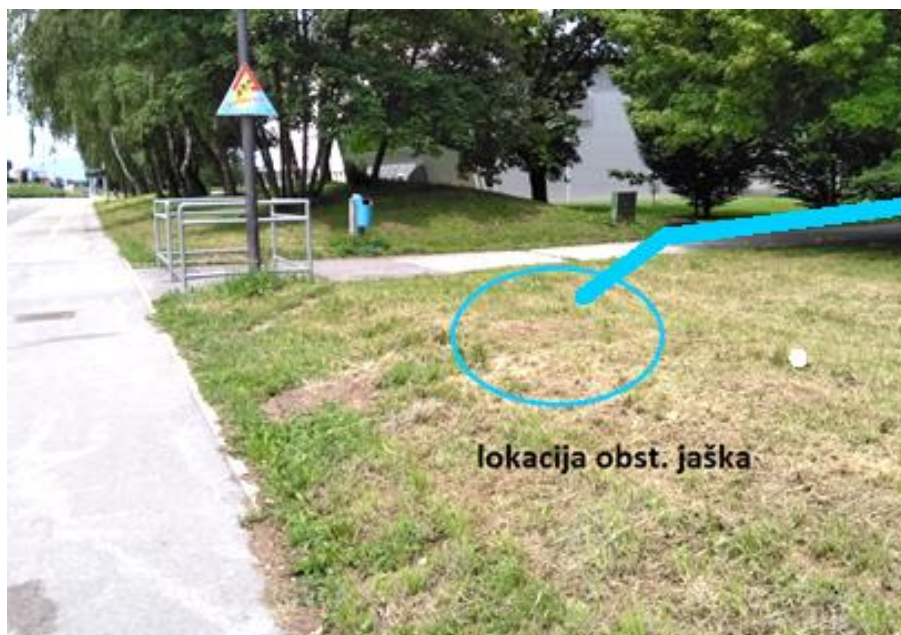
obstoječi jašek na primarnem vodovodu
